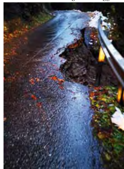
Schwere Beschädigungen der Heitzelsberger Straße an 4 Stellen.
