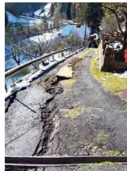
Durch den starken Regen wurde dieser Zufahrtsweg teilweise weggerissen.
