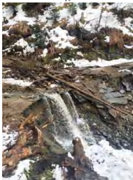
Die Zufahrt zu vlg. Zwinger ist auf Grund eines Erdbebens derzeit nicht möglich.
