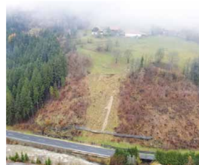
Beim Drehtalgraben sind Risse entstanden. Diese drohen auf die B99 abzurutschen.
